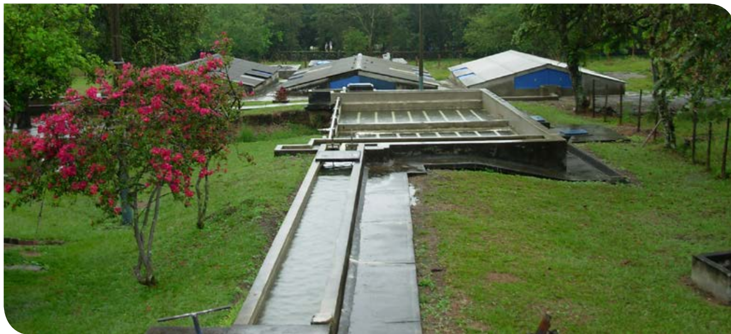
● Planta de Tratamiento y filtración en multiples etapas La Sirena – Foto: Cortesía Instituto CINARA.
